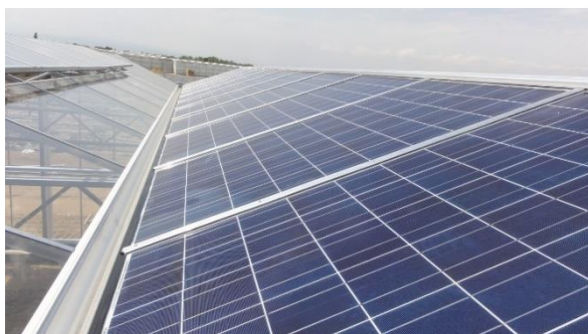
Serres photovoltaïque SAINT LAURENT D'AIGOUZE (30) Puissance électrique : 4.4 MWc Mise en service : Décembre 2011
